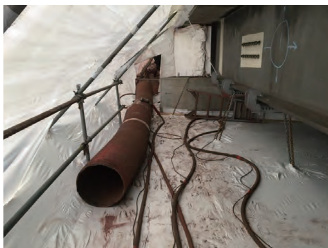
集塵ダクト及び 封じ込め朝顔内部区画
